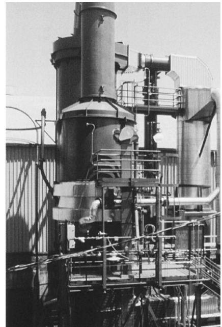
EQUIPO DE GENERACIÓN DE VAPOR. Gasifica barro residual procedente de la recuperación de papel en la ciudad de California, USA.
